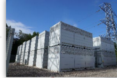
ENERGY SUPERHUB OXFORD 5 MWh VS3 / Oxford
