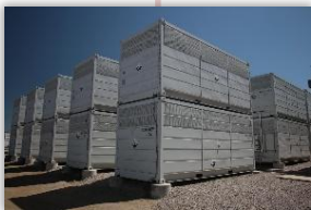
VIEJAS MICROGRID (CEC) 10 MWh VS3 / California
