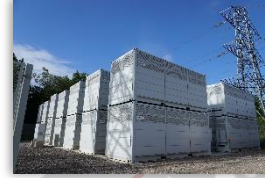
ENERGY SUPERHUB OXFORD 5 MWh VS3 / Oxford
