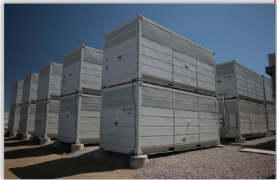
VIEJAS MICROGRID 10 MWh VS3
