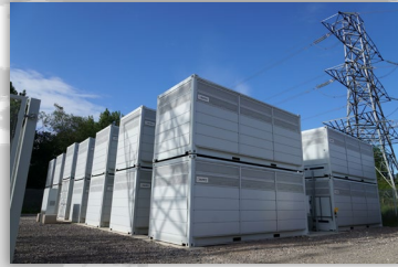
ENERGY SUPERHUB OXFORD 5 MWh VS3
