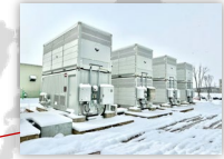
KEPCO 1.5 MWh VS3
